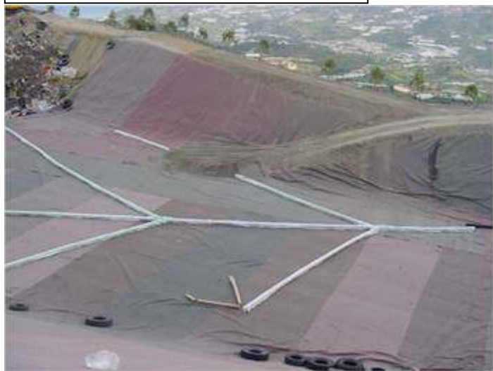
Rete di drenaggio biogas su fondo discarica
